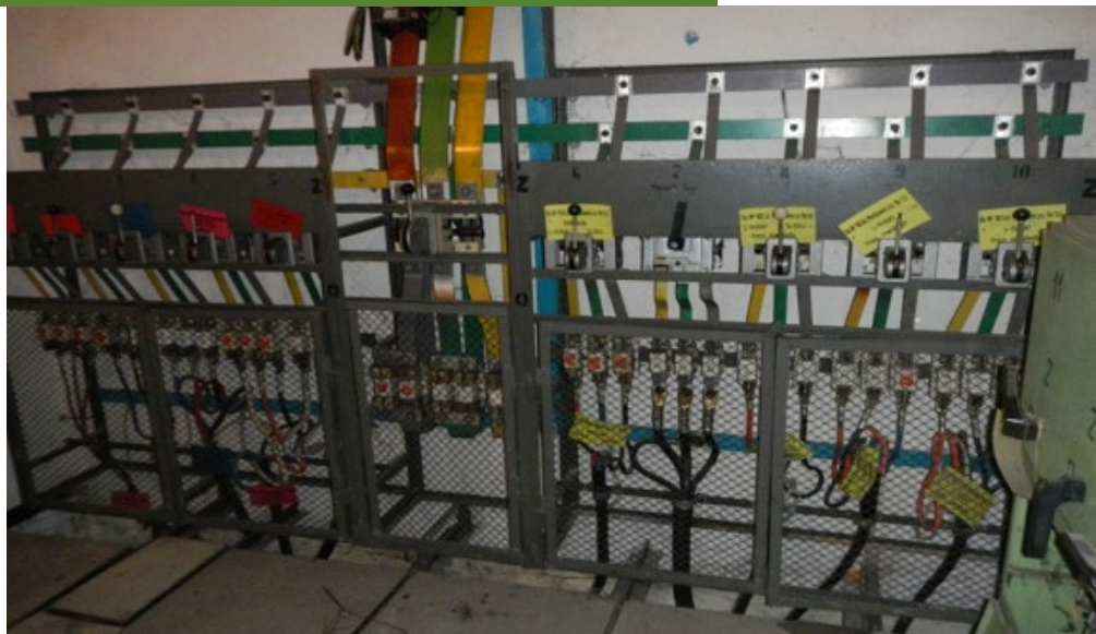
Rys. 1 Wnętrze T-2846 Stacja transformatorowa przy WSM im. A. Mickiewicza w Sopocie w Sopocie przed modernizacją (Robert Klein, Energa-Operator SA, 2023).
