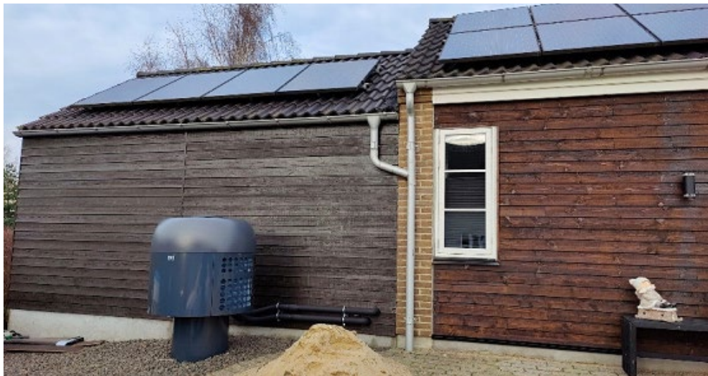
Rys. 2: Instalacje wewnętrzne w jednym z gospodarstw objętych projektem - pompa ciepła i system fotowoltaiki PV (Neogrid Technologies, 2023).
