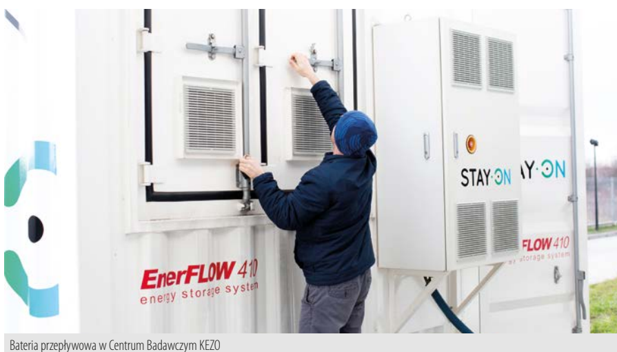
Bateria przepływowa w Centrum Badawczym KEZO
